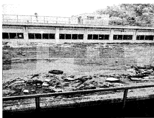
＜写真4＞ 津波の直接的被害を受けた鳴瀬第二中学校
